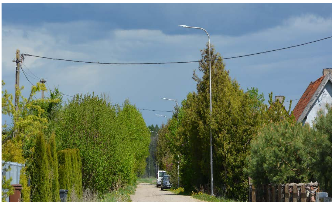
Nowo powstałe oświetlenie w Dąbrowie/Kolonia
