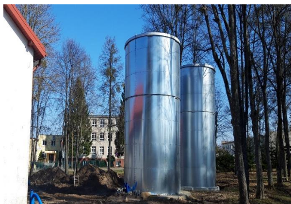
Stacja Uzdatniania Wody w Bezledach
