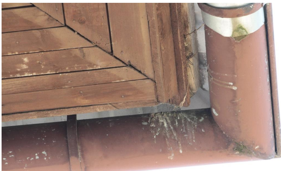
Fot. 9. Materiał gniazdowy w elementach konstrukcji dachu (szczelina wentylacyjna) (fot. L.K.).
