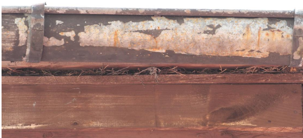
Fot. 6. Materiał gniazdowy w elementach konstrukcji dachu (szczelina wentylacyjna) (fot. L.K.).
