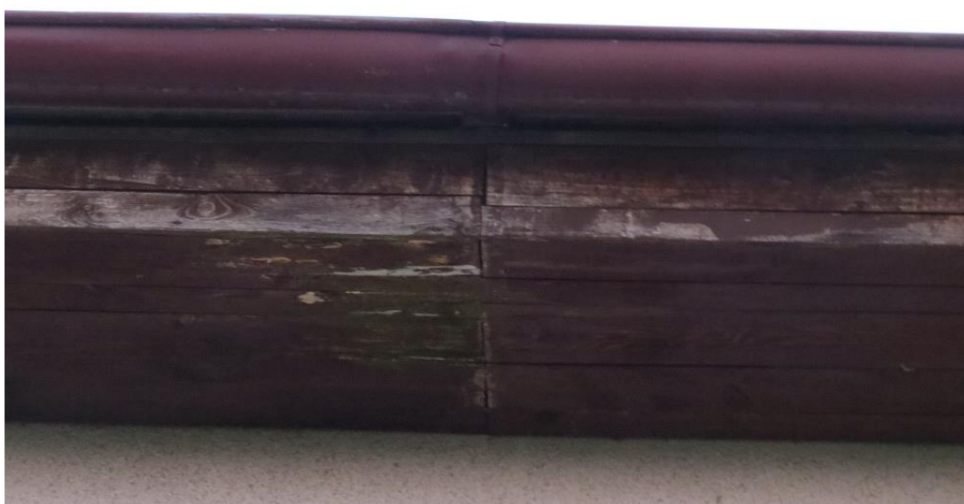
Fot. 14. Szczeliny w drewnianych elementach konstrukcji dachu – potencjalne kryjówki nietoperzy.
