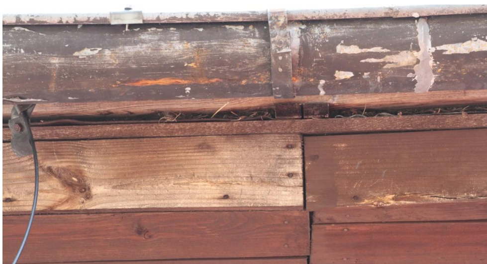
Fot. 5. Materiał gniazdowy w elementach konstrukcji dachu (szczelina wentylacyjna) (fot. L.K.).
