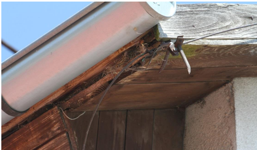
Fot. 8. Materiał gniazdowy w elementach konstrukcji dachu (szczelina wentylacyjna) (fot. L.K.).
