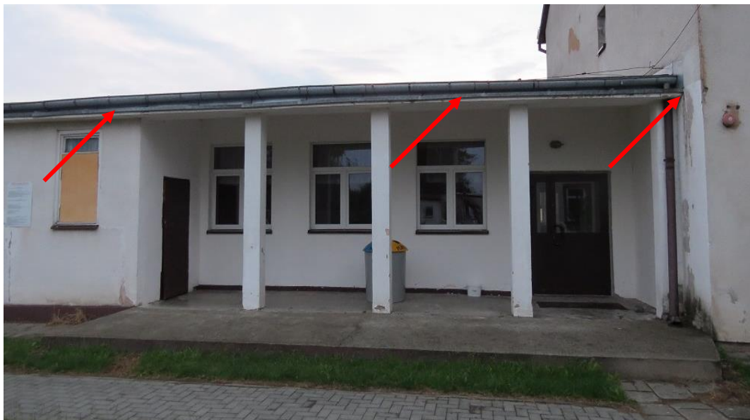
Fot. 16. Sala gimnastyczna - elewacja południowa – strzałkami zaznaczono potencjalne kryjówki nietoperzy w obrębie stropodachu.
