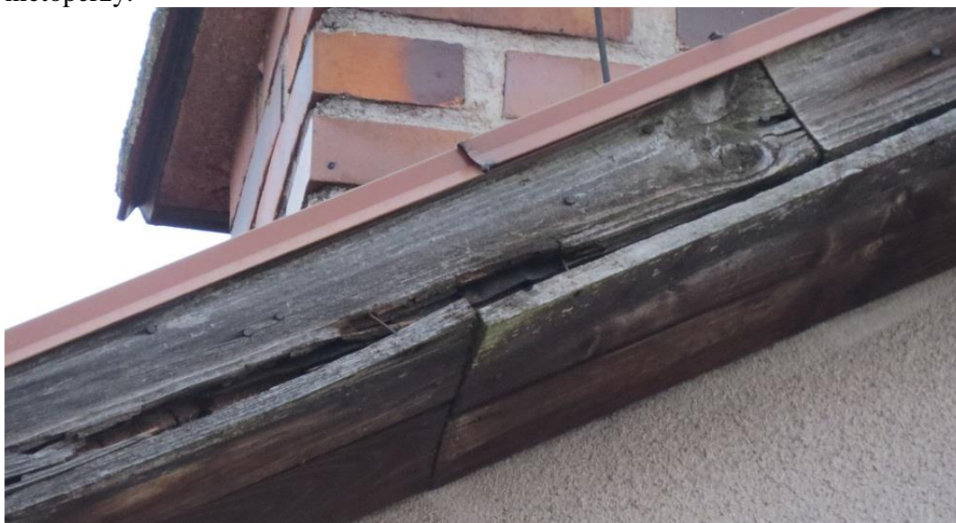
Fot. 15. Szczeliny w drewnianych elementach konstrukcji dachu – potencjalne kryjówki nietoperzy.
