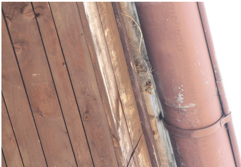
Fot. 10. Materiał gniazdowy w elementach konstrukcji dachu (szczelina wentylacyjna) (fot. L.K.).
