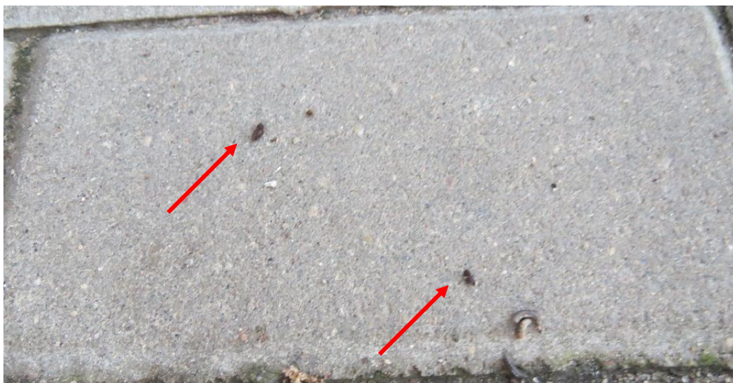
Fot. Pojedyncze, rozproszone odchody nietoperzy przy północnej elewacji budynku
