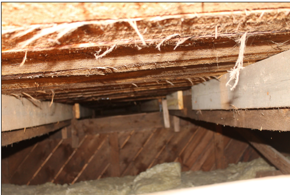
Fot. nr 6. Widok dźwigara konstrukcji dachowej ponad wyższą częścią budynku. Widoczne również płatwie wykazujące duże ugięcie oraz nadbitki jak i deskowanie połączeń dachowej.
