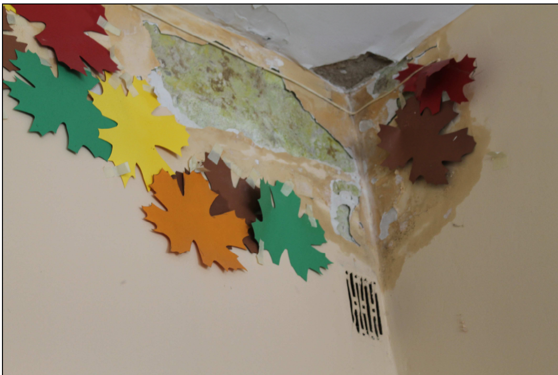
Fot. nr 4. Widok zawilgoconych tynków wewnętrznych w korytarzu.
