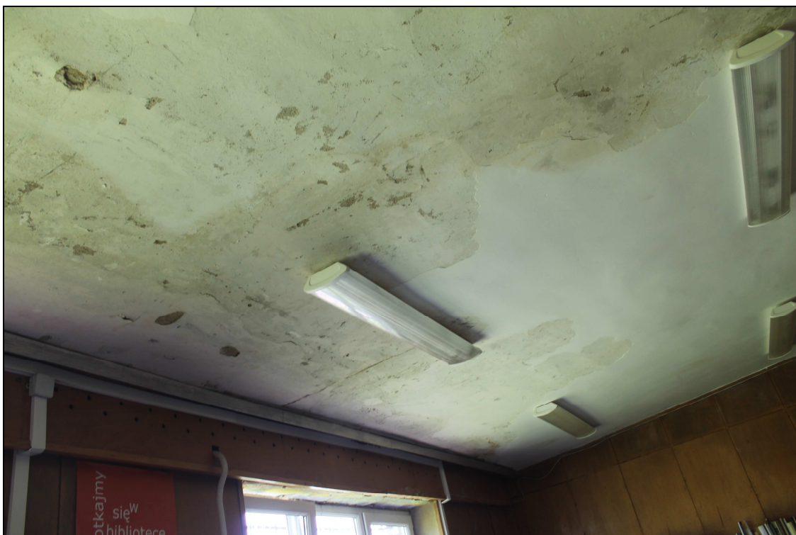
Fot. nr 5. Widok zawilgoconych tynków wewnętrznych sufitów w pomieszczeniu biblioteki.
